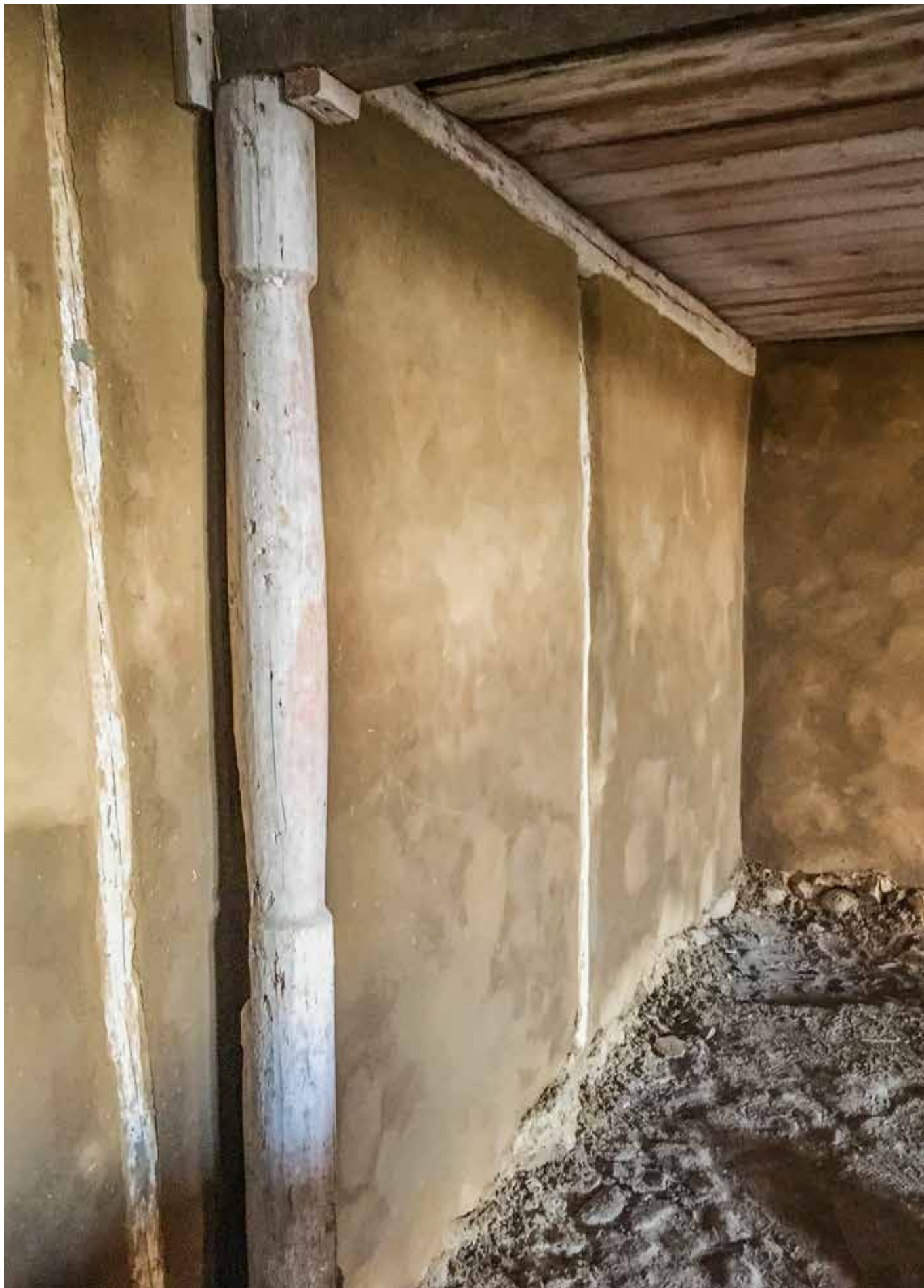
I denna gamla maskinhall med anor utanför Trelleborg valde man att använda Hyllingegårdens Lerbruk. Både Hyllingegårdens Lerbruk | GROV och Hyllingegårdens Lerbruk | MELLAN användes. Då det är en maskinhall som fotrfarande används så avslutades inte lerputsens med Hyllingegårdens Lerbruk | FIN.
